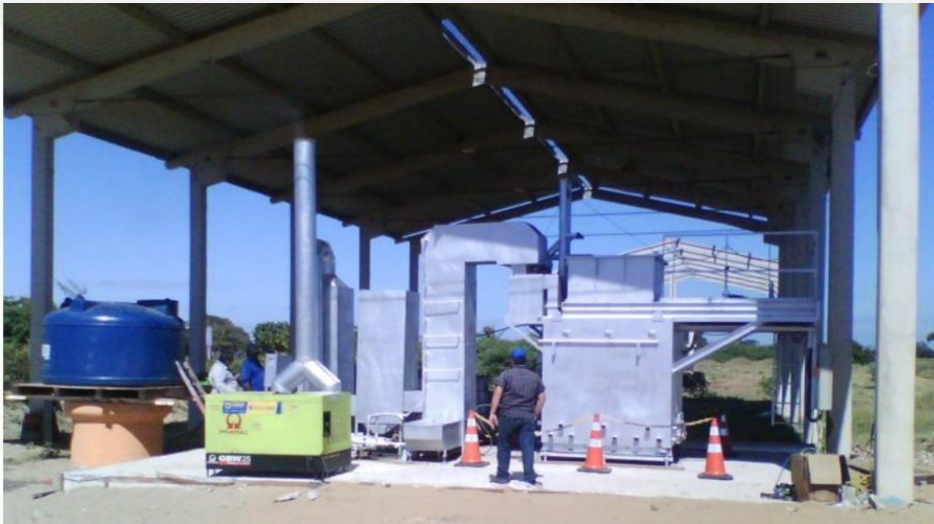
Visão geral da unidade para tratamento de 10 t/d de resíduos
